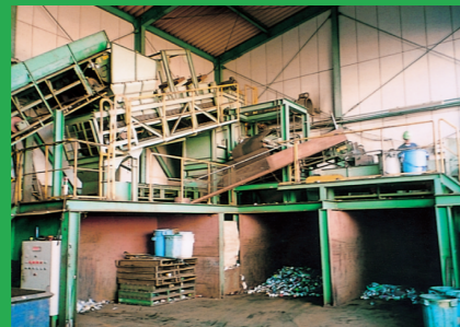
Máquina de seleção automática As latas de aço são separadas das de alumínio através de atração magnética.
