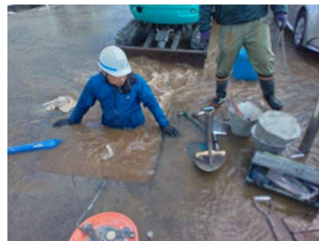
上段:漏水状況、下段:修繕状況
