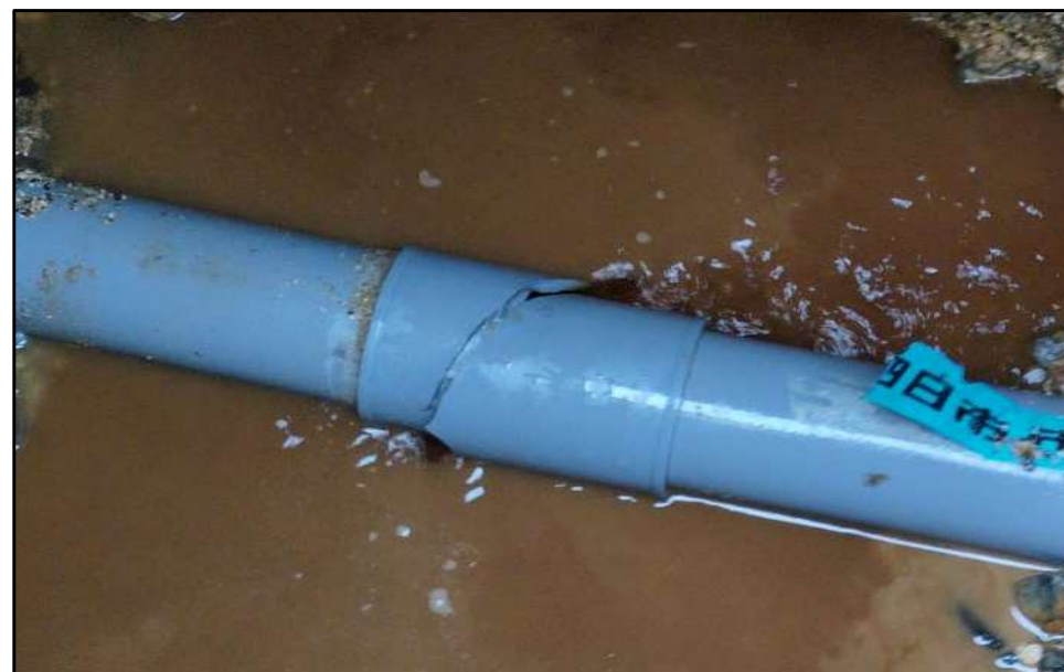
破損状況(昭和40年代に布設された塩ビ管)
