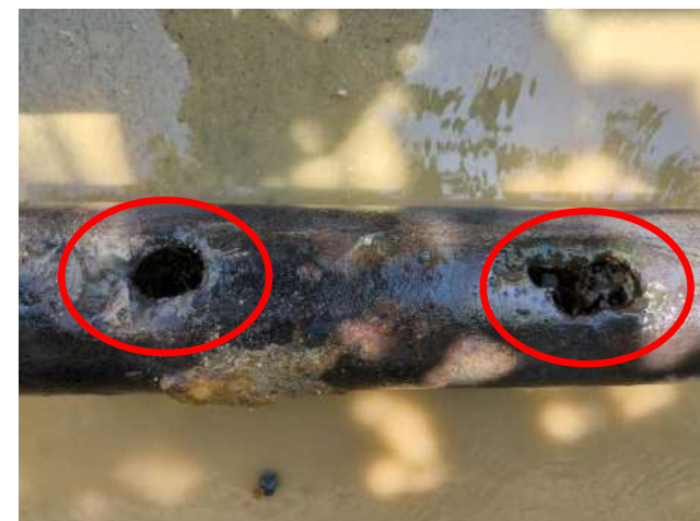
漏水状況(鋳鉄管)
