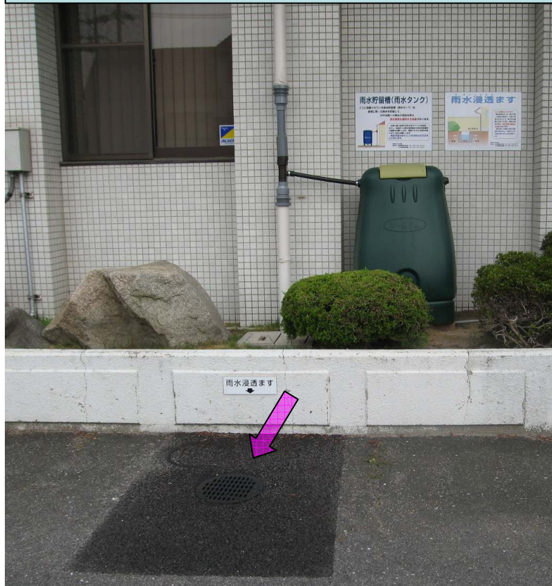
楠総合支所にて【雨水貯留タンクと雨水浸透ます】
