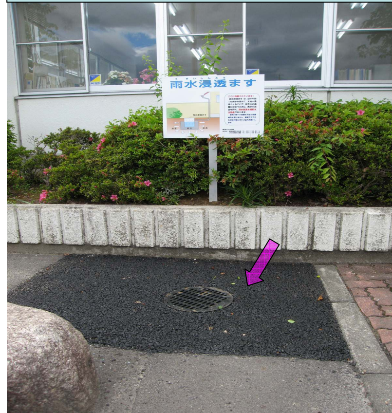
川島地区市民センターにて【雨水浸透ます】
