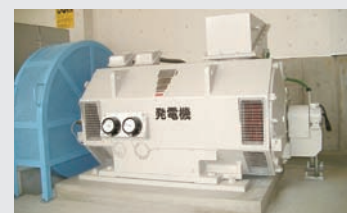
高岡配水池小水力発電所発電機
