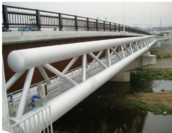
耐震化された水管橋
