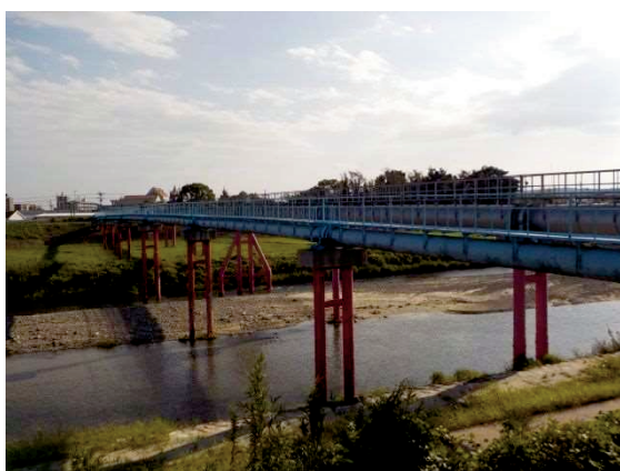
水管橋 (三滝川)
