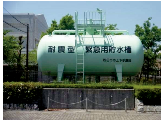
耐震型緊急用貯水槽 (楠中央緑地内)
