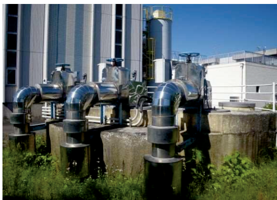
三滝3号井の取水井 (井戸)
