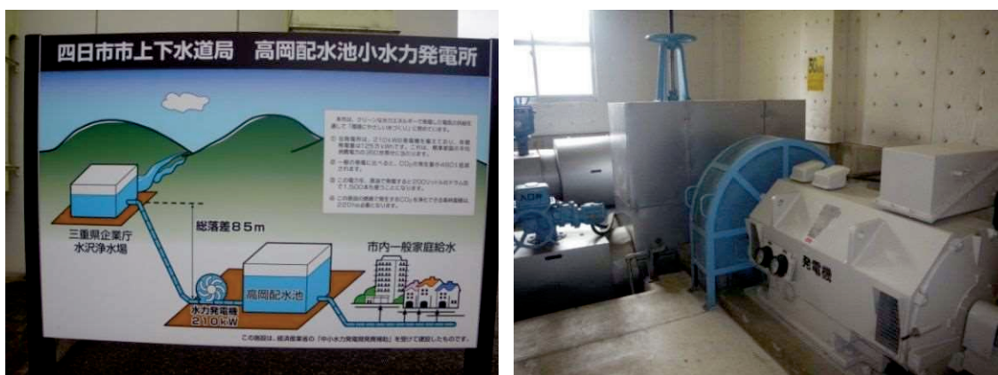
高岡配水池の小水力発電設備
