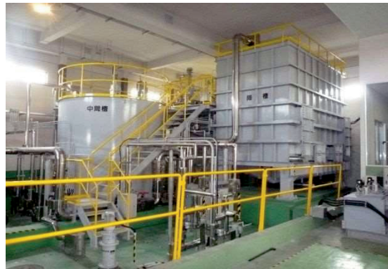
朝明水源地の消石灰注入設備
