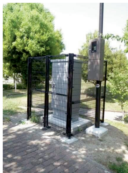
水質自動監視装置
