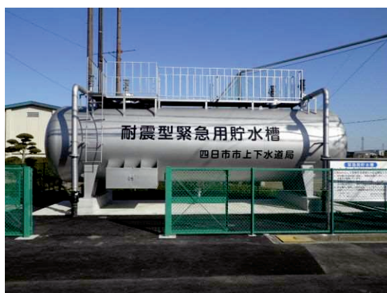
耐震型緊急用貯水槽（河原田小学校内）
