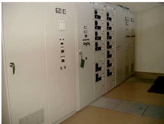
受変電・配電設備
