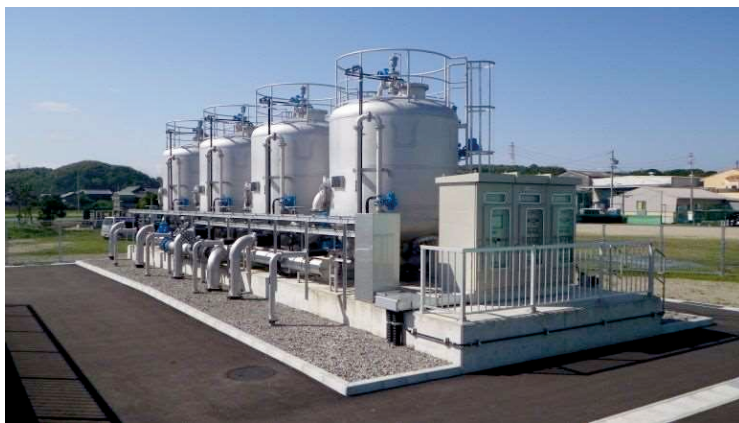
朝明水源地の除マンガン設備
