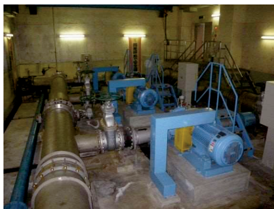
朝明水源地の送水ポンプ設備
