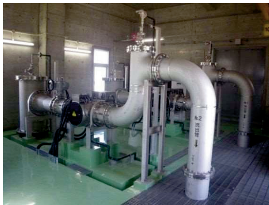
朝明水源地の紫外線照射設備
