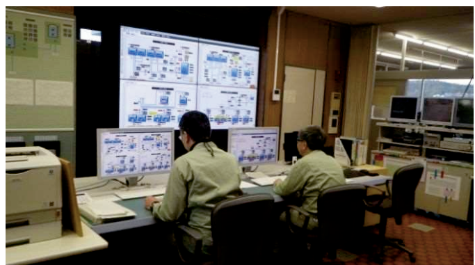
遠方監視システムによる監視の様子
