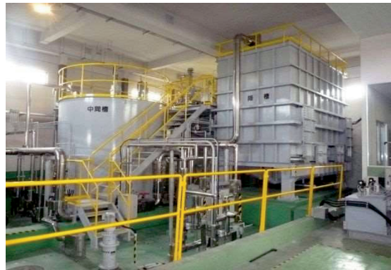
朝明水源地の消石灰注入設備
