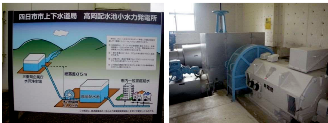
高岡配水池の小水力発電設備
