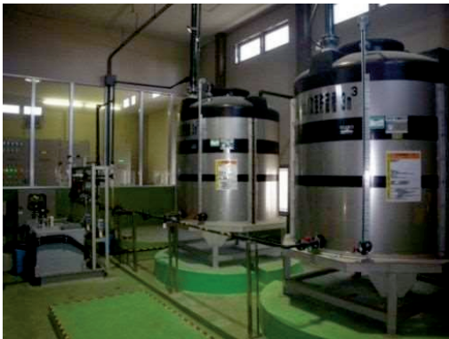
朝明水源地の塩素消毒処理設備
