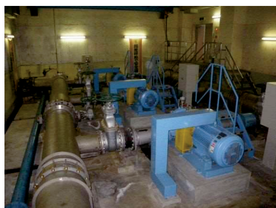
朝明水源地の送水ポンプ設備
