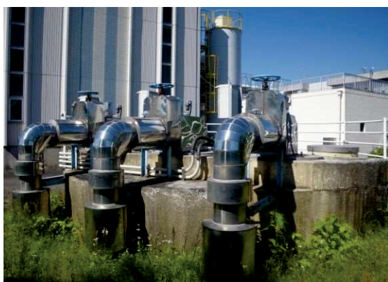
三滝3号井の取水井（井戸）
