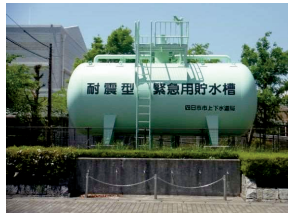
耐震型緊急用貯水槽（楠中央緑地内）
