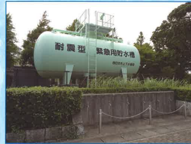
【应急用蓄水槽（地上）】 这里是地上的应急用蓄水槽。
