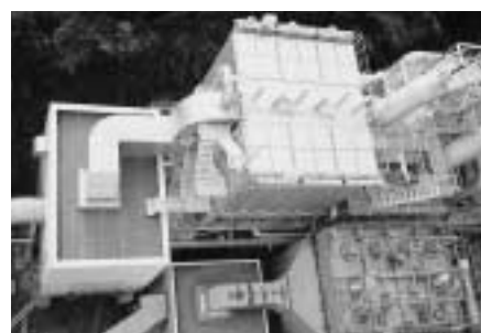
昨年10月に完成した三号炉のバグフィルター
