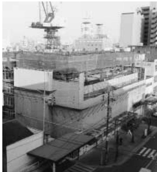
市の補助制度を利用した民間によるマンションの建設現場
